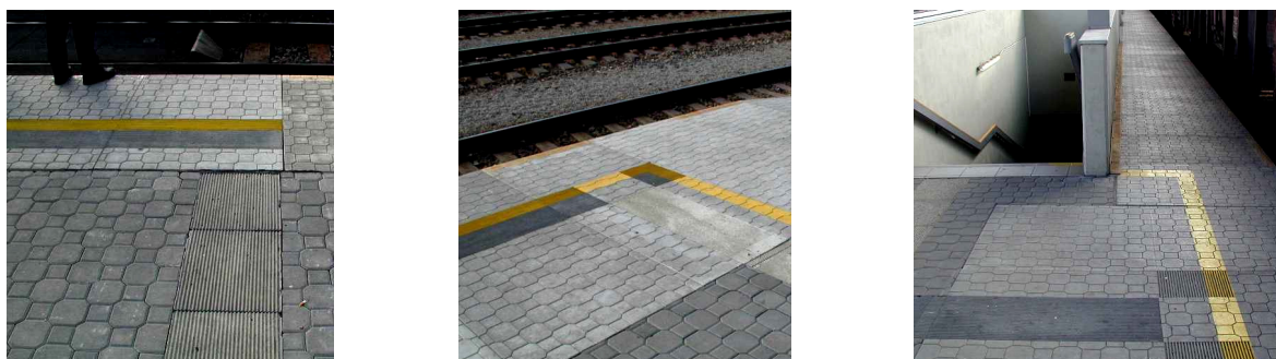
Obr. 13: Nesprávné řešení některých hmatových úprav na ostrovním nástupišti železnice
