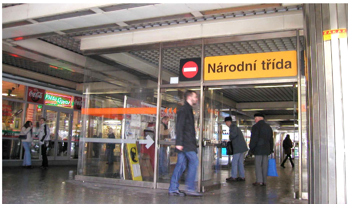
Obr. 10: Barevně kontrastní označení prosklených stěn a vstupních dveří
