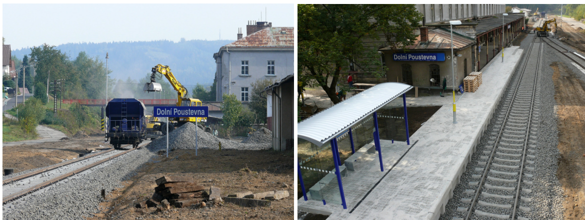
Obrázek 5 – Záběry z dokončování rekonstrukce dopravy Dolní Poustevna v souvislosti s obnovením železničního hraničního přechodu
