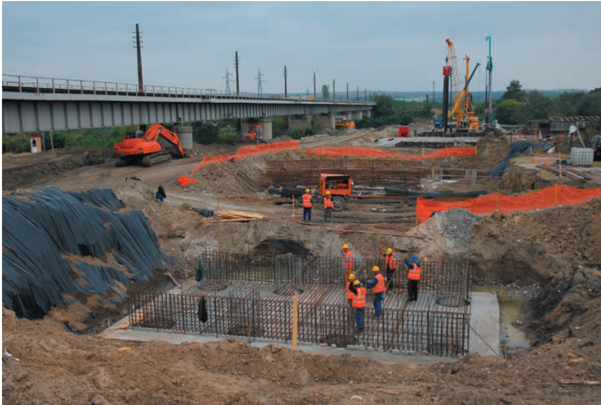
Obr. 2 Snímek z výstavby betonového mostu pře řeku Maricu, na pozadí stávající ocelový most
