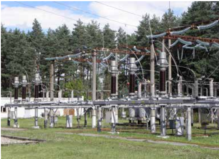
Obr. 5: Napájecí stanice Saulkrasti
