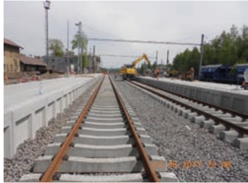
Obr. 3 – Žst. Chodov, staniční koleje č. 2, 4, vč. nástupišť
